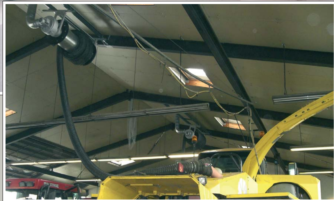
Schlauchaufroller mit Aluminiumgussgehäuse und Motorantrieb für eine Landmaschinenwerkstatt.
