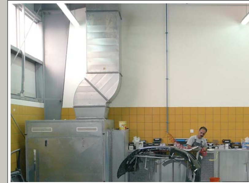
Überflur-Füllerabsaugung in einer Lackiervorbereitungshalle.
