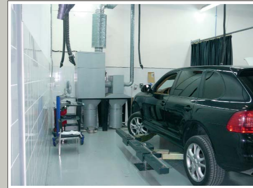
Hochvakuum Filteranlage mit Funkenschutzüberwachung (500 m 3 /h) für 2 Alu-Arbeitsplätze in der Karosseriewerkstatt.
