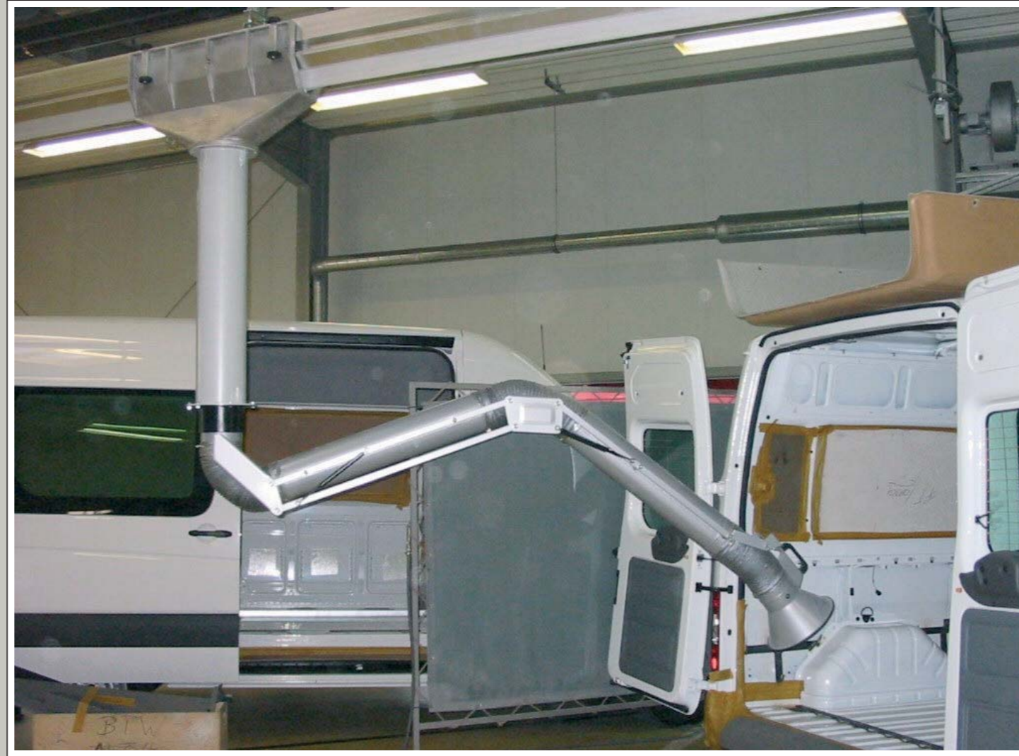
Laufwagen im SSK 290 mit Verlängerungsrohr und Absaugarm NW 160 für die punktuelle Erfassung von Schadstoffen.
