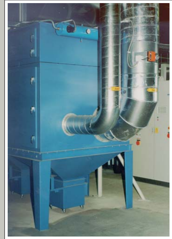
Patronenfilter – Zentralanlage für 12000 m 3 /h für Schweißrauch und Schleifplätze in einem Bahnbetriebswerk.
